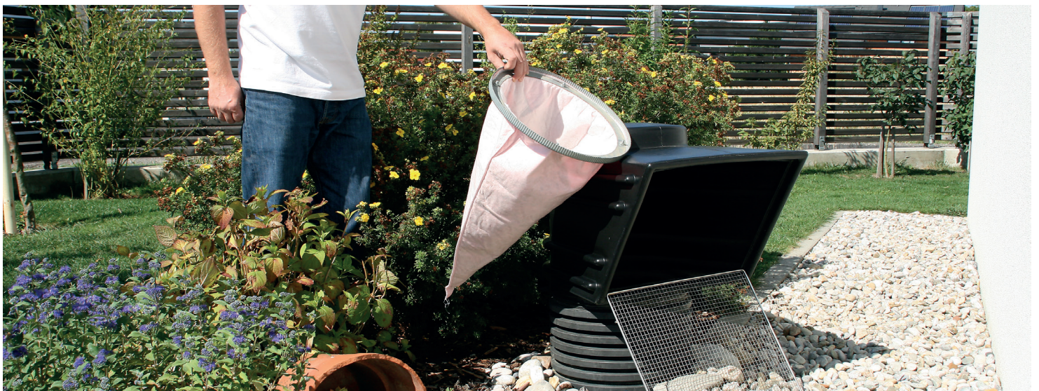
Wechsel des Taschenfilters bei einer Außenluftansaugung
